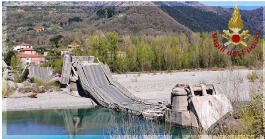
Foto: il ponte crollato. Crediti foto: Vigili del Fuoco .
